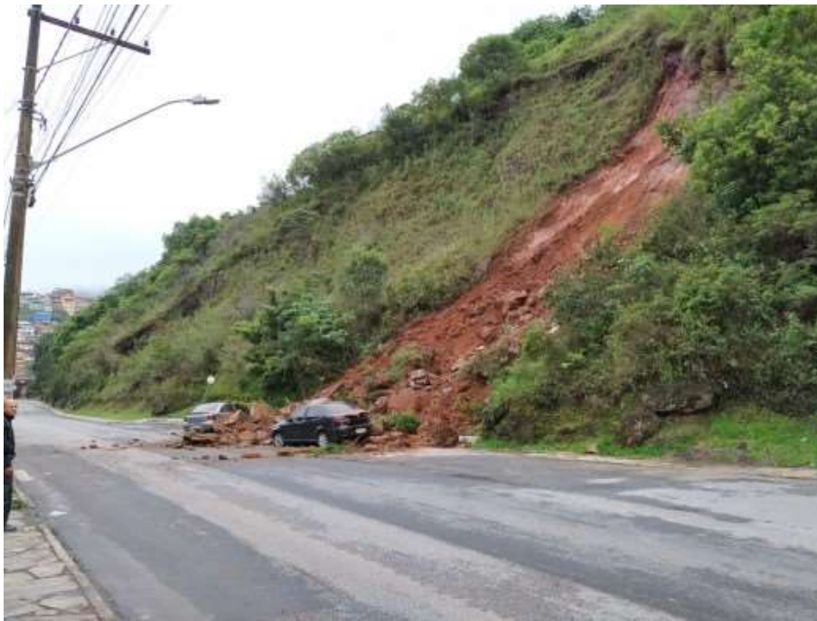
Figura 14- Vista do deslizamento em 2019 na rua Padre Rolim
