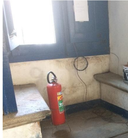
Figura 35 - Extintor de Incêndio.
