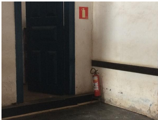
Figura 36 - Extintor de Incêndio.
