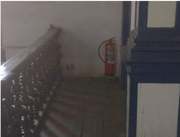
Figura 34 - Extintor de Incêndio.
