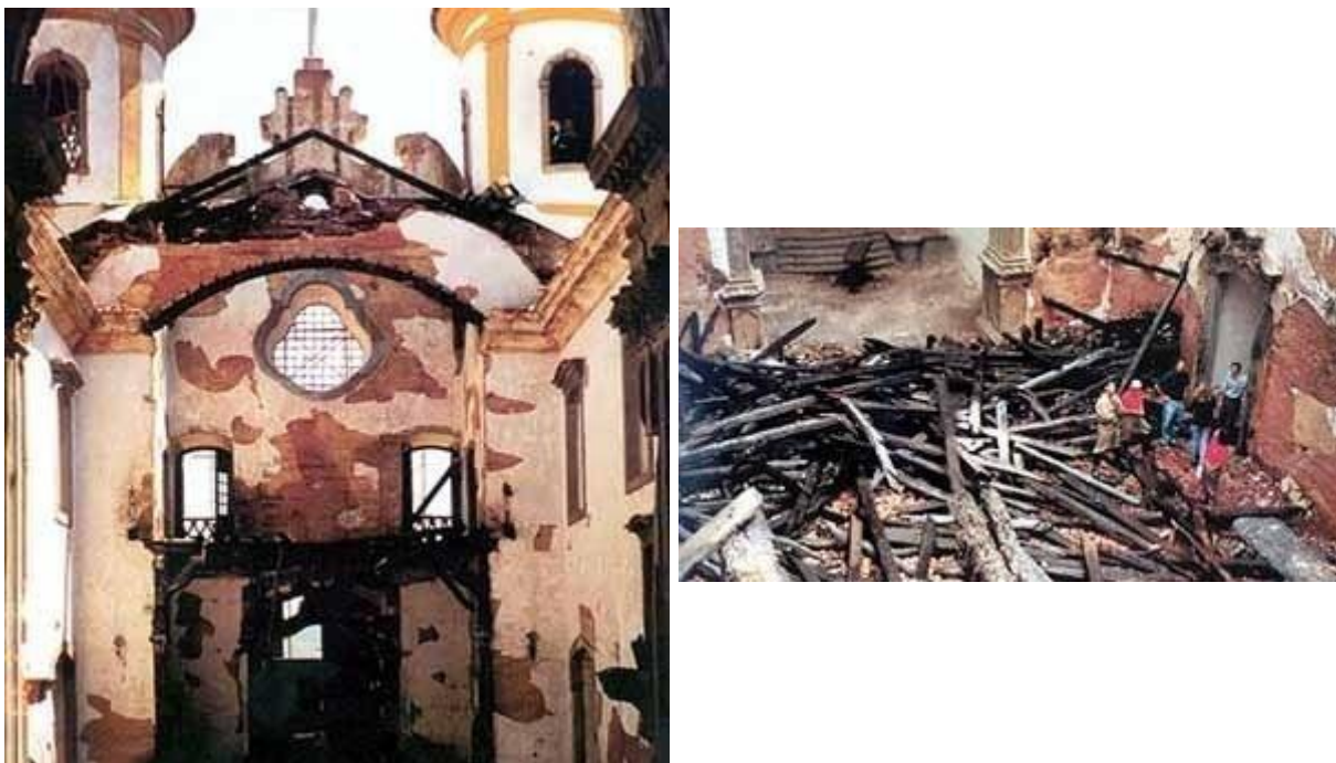
Figura 13 - Danos causados pelo incêndio na igreja de Nossa Senhora do Carmo.
