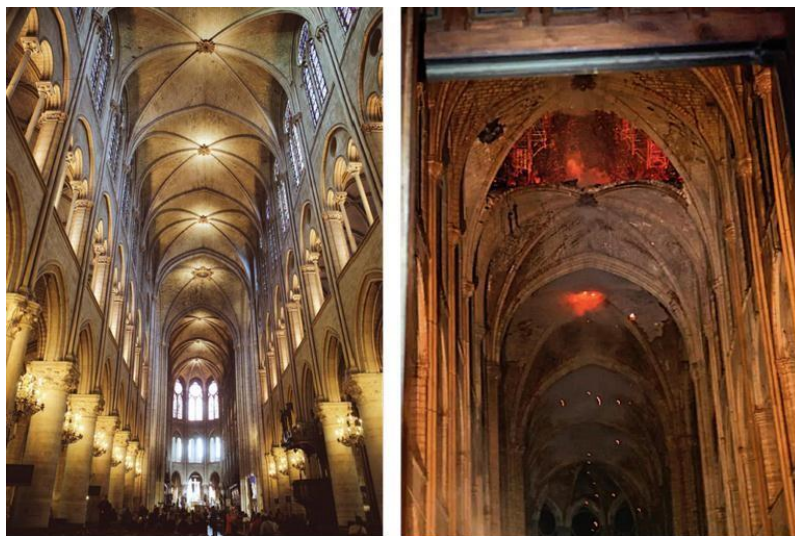
Figura 17 - Antes e depois: Danos causados pelo incêndio no forro.
