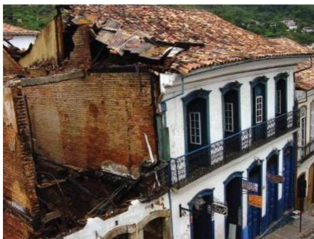
FIGURA 2 - Insuficiência de isolamento entre edificações.
