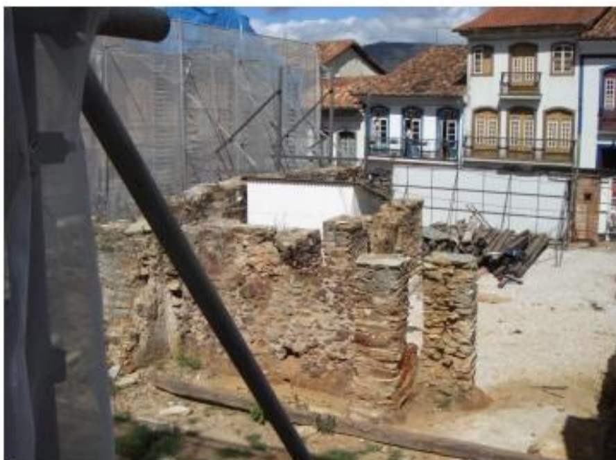
Figura 25 - Ruínas do sobrado Pilão- OP/ 2005 Vista geral interna
