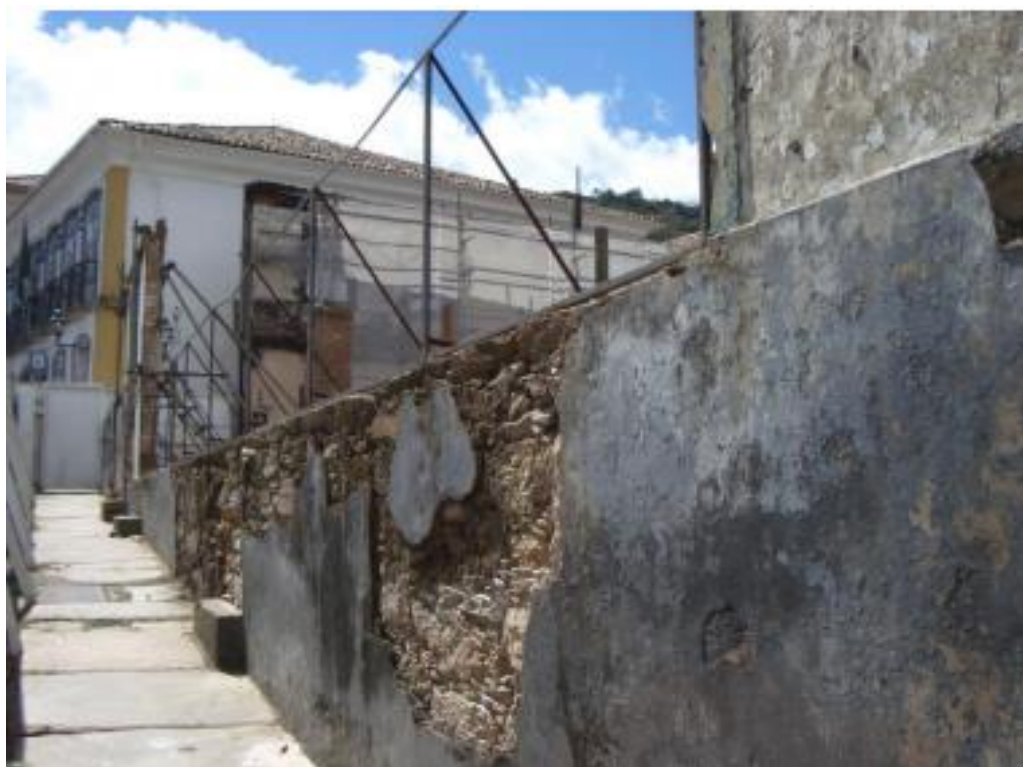
Figura 26 - Ruínas do sobrado Pilão- OP/ 2005 Vista parcial fachada Praça Tiradentes
