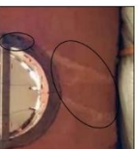
10: Mancha de umidade na parede e ataque de xilófagos na janela
