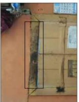
1: Mancha negra na janela da sala
