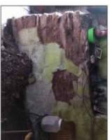
3: Perda da camada de reboco e pintura no portão
