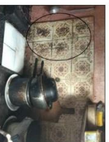
6: Mancha negra no revestimento da cozinha
