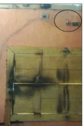
3: Mancha negra na janela e vício de construção na parede
