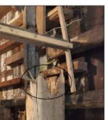
7: Barrote quebrado no portão
