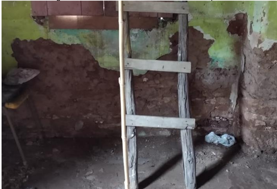
Figura 18 – Perda da camada de reboco no porão
