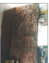
4: Perda da camada pictórica e da camada de reboco no portão
