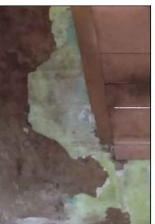
8: Perda da camada pictórica e de reboco no porão
