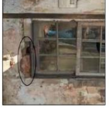
9: Perda da camada de reboco na fachada esquerda
