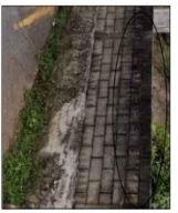
5: Mancha negra na parte superior do muro
