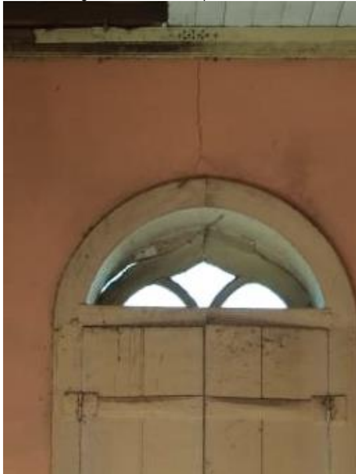
Figura 17 – Trinca na parede da sala
