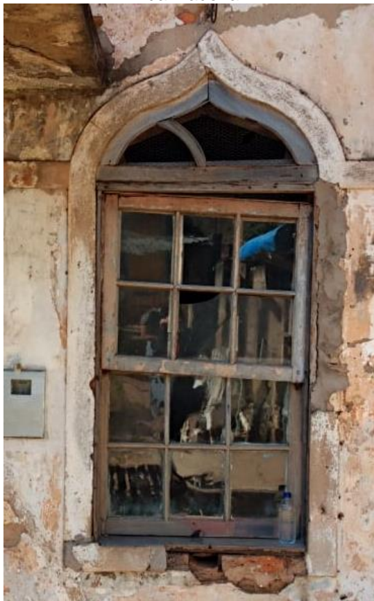
Figura 21 – Apodrecimento e ressecamento da madeira
