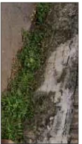
4: Presença de vegetação de pequeno porte na fachada frontal
