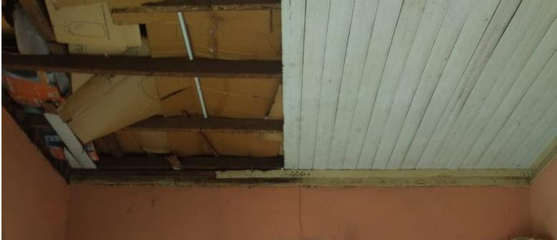
Figura 22 – Perda parcial do forro na sala
