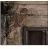
2: Perda da camada pictórica na fachada frontal
