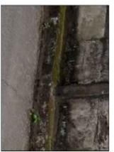
1: Biofilme e mancha negra no muro frontal
