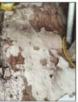
6: Perda da camada de reboco no porão
