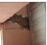
4: Perda da camada de reboco na parte superior da parede do banheiro
