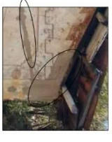
8: Vício de construção na fachada esquerda
