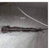
5: Perda da camada de reboco no banheiro
