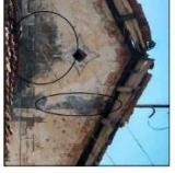
7: Mancha de umidade e mancha negra na fachada esquerda
