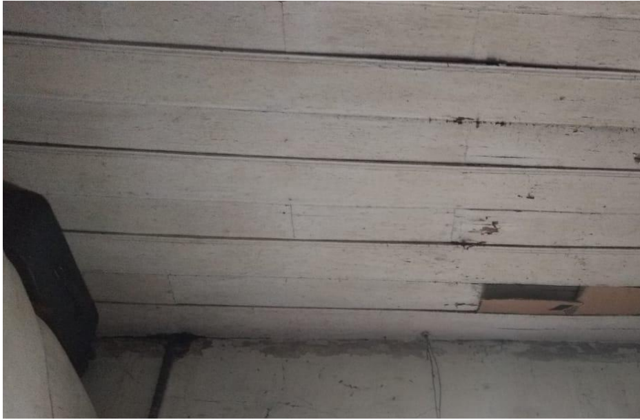
Figura 15 – Forro saia e camisa no quarto 3
