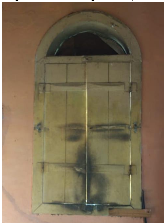
Figura 19 – Mancha negra nas esquadrias
