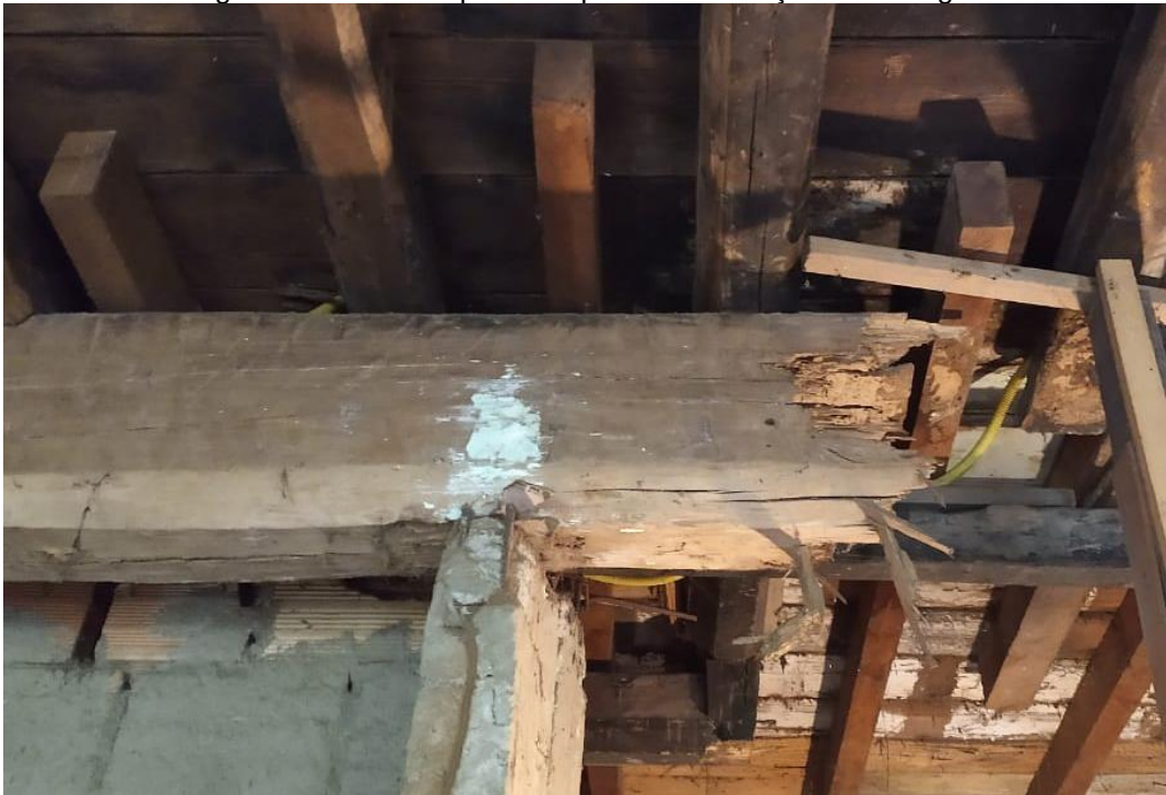
Figura 24 – Barrote quebrado por causa da ação de xilófagos
