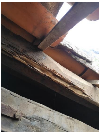
Figura 15 – Caibros com presenças de xilófagos
