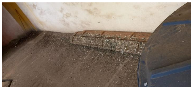
Figura 18 – Sujidade na Varanda do consistório
