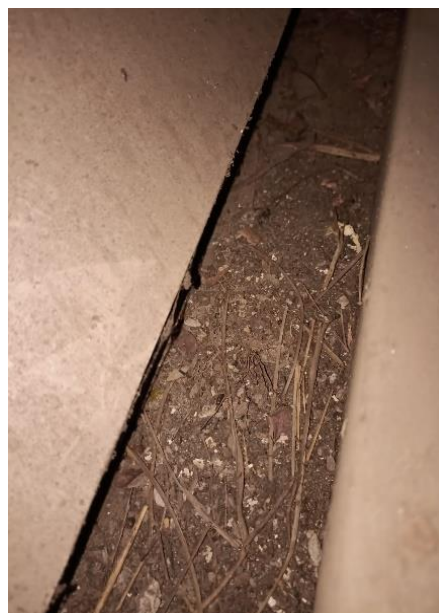
Figura 28 – Sujidade encontrada nas calhas internas
