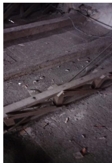
Figura 16 – Sujidade no verso do forro do consistório
