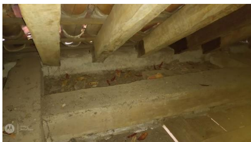
Figura 17 – Sujidade no verso do forro da nave
