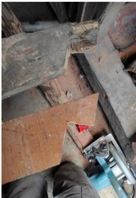
Figura 25 – Peça de caibro, antiga e de substituição
