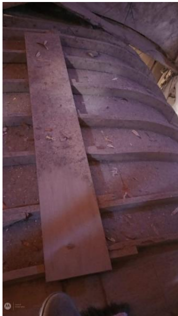
Figura 13 – Sujidade no verso do forro do camarim
