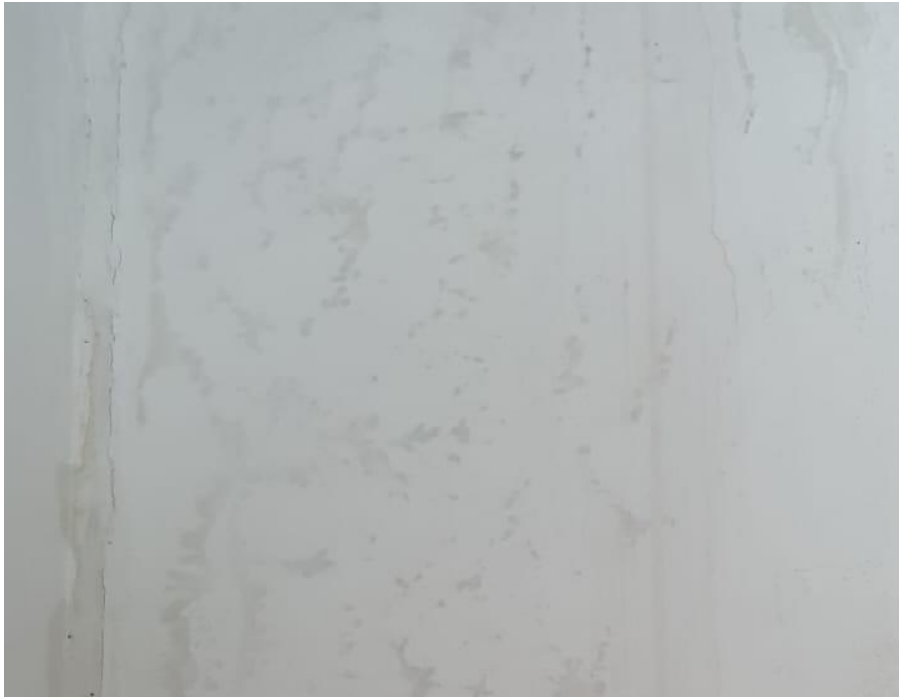
Figura 48 - Dano por infiltração.
