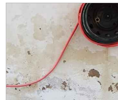
3- Mancha de umidade causada pela infiltração na área de banho.
