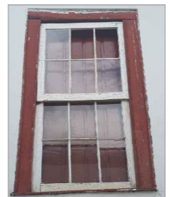
8- Perda da vedação - vidro, devido o ressecamento da massa, fortes chuvas de granizo que quebrou alguns dos vidros.
