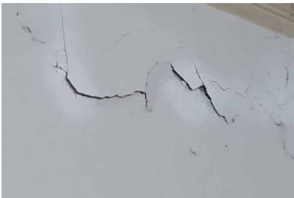
Figura 53 - Patologia no revestimento.
