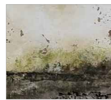
6- Pátina biológica e surgimento de musgo devido a umidade da área molhada do banheiro.
