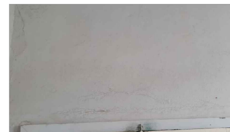
1- Mancha de umidade proveniente do acúmulo de matéria orgânica do lado externo, causando bolhas na camada pictórica e pequenas fissuras no reboco.
