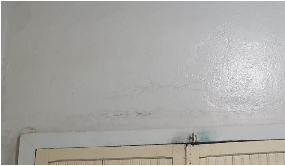
Figura 56 - Patologia no reboco.
