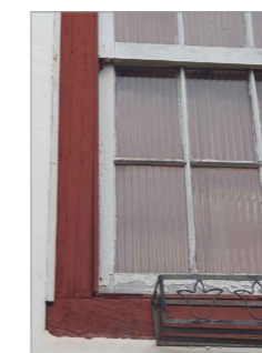
4- Ressecamento da madeira devido a grande exposição a intempéries.
