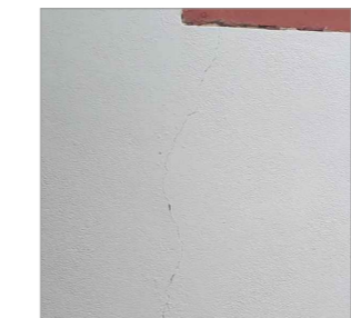
9- Fissura no reboco em razão ao movimento de tráfego de veículos pesados.
