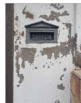
2- Destacamento parcial da camada pictórica.
