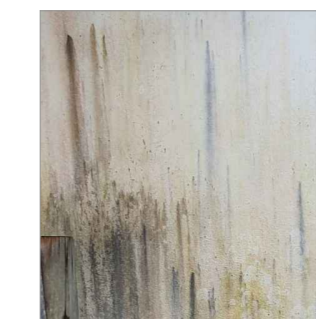
4- Biofilme e fungos na parede por ser um local úmido e fresco proporcionando desenvolvimento dessas patologias.
