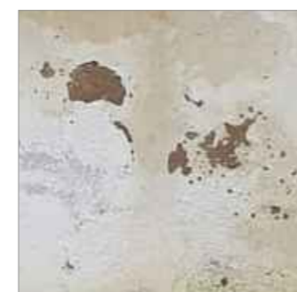
2- Destacamento parcial da camada pictórica.
