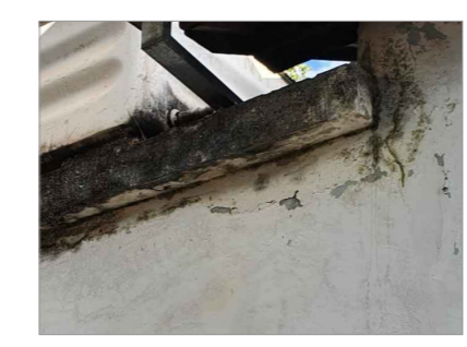
4- Patina biológica onde se concentra a infiltração.
