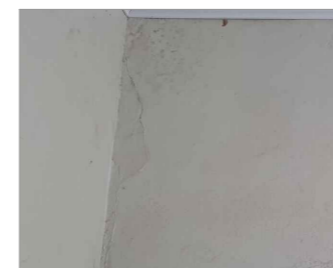
2- Mancha de mofo vinda do acúmulo de matéria orgânica do lado externo, causando fissuras no reboco.
