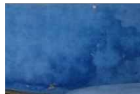
3- Mancha generalizada de umidade causada pela capilaridade e falta de impermeabilização na base da edificação.
