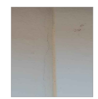
1- Fissura proximo a viga na camada do reboco.
