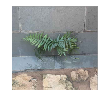
3- Vegetação de pequeno porte próximo a base da parede.
