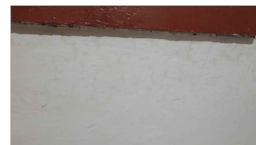
4- Mancha de umidade por capilaridade e/ou por infiltração da janela.
