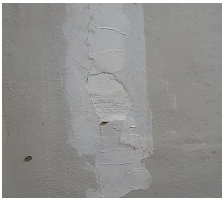
Figura 54 - Patologia com intervenção inadequada na copa.
