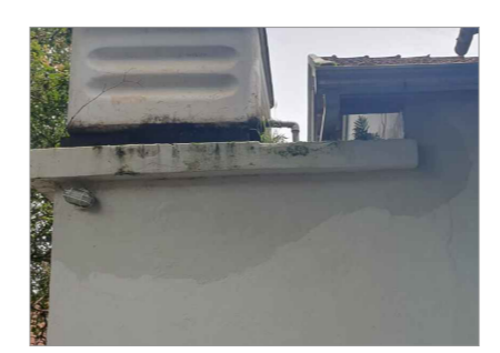
2- Mancha de umidade na parte superior da parede devido ao acumulo de água pluvial sem escoamento devido.
