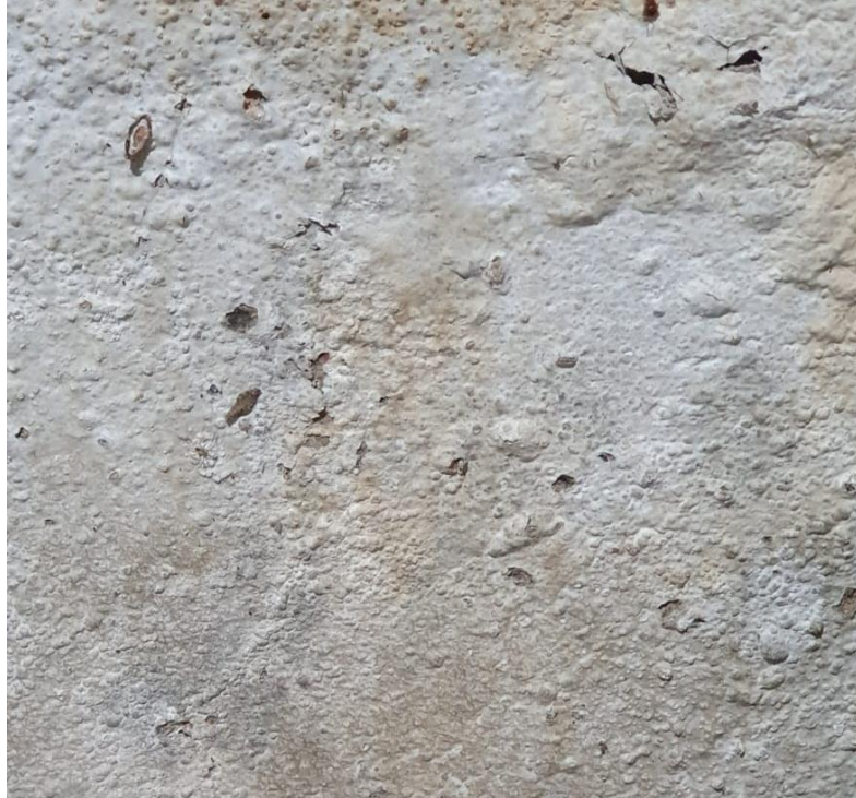
Figura 51 - Patologia parede quarto 3
