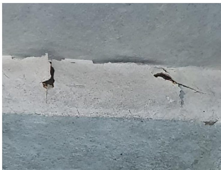
Figura 58 - Patologia no concreto do banheiro.
