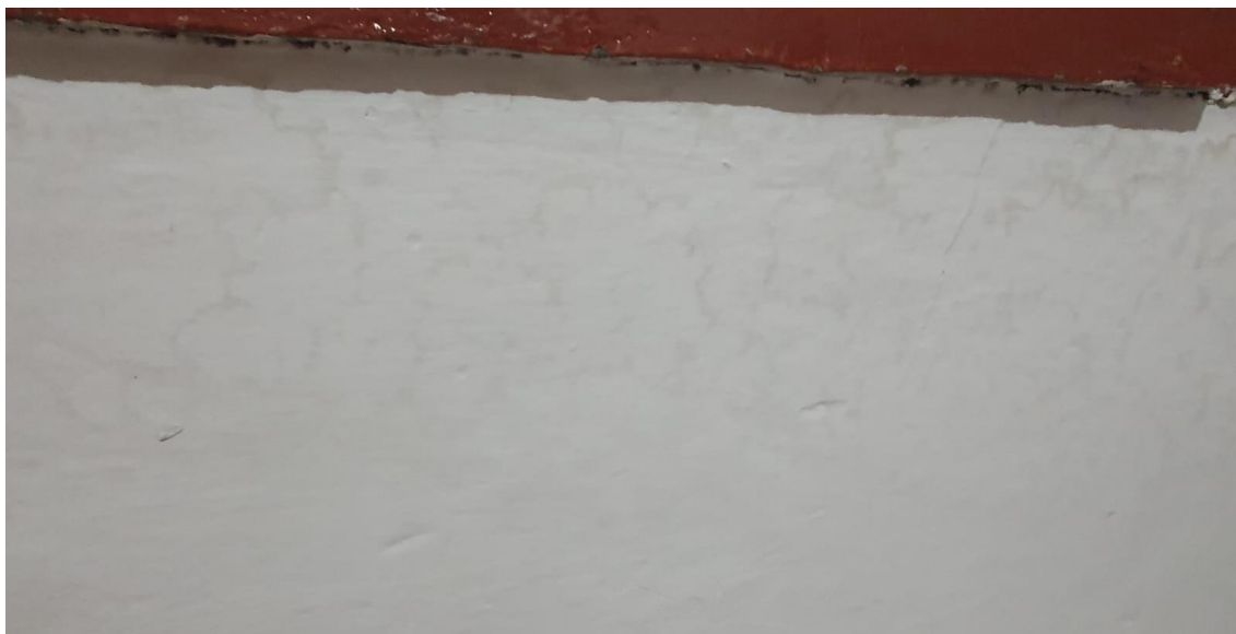
Figura 47 - Dano por infiltração.
