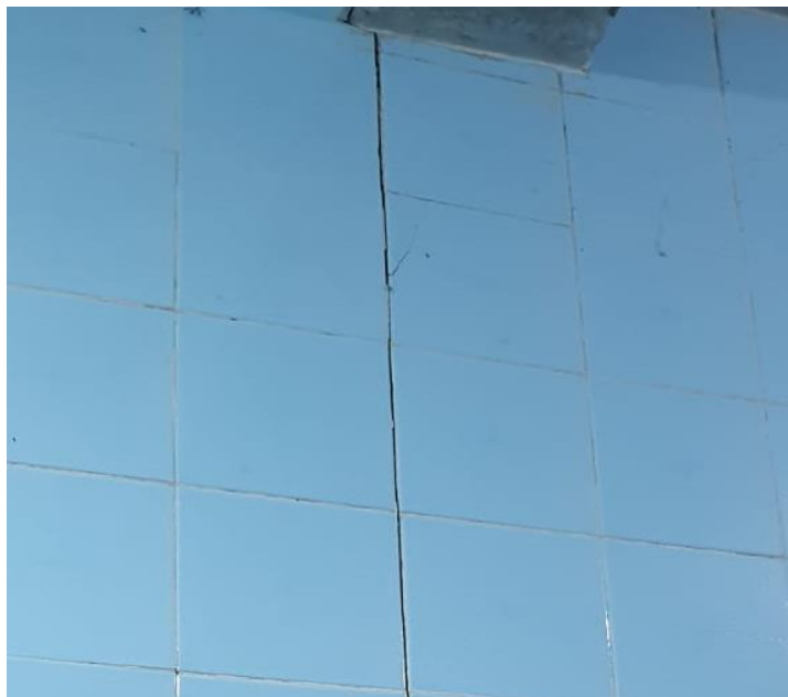
Figura 57 - Patologia no azulejo do banheiro.
