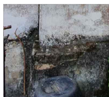
4- Destacamento da alvenaria e exposição da estrutura de tijolos devido a erosão da argamassa cimentícia.
