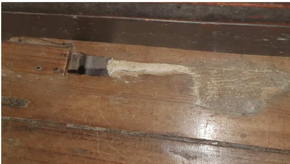
Figura 52 - Piso atacado por xilófagos.
