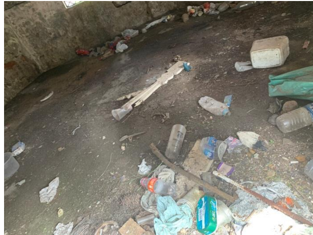
Figura 24: Entulho no porão Fonte: Flávio Junior, 2021.
