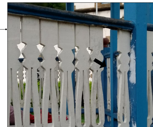
E – Detalhe perda do suporte na balastrada Foto: Flávio Junior, 2019.
