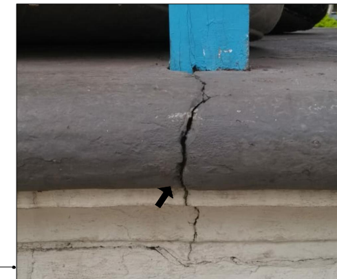
C – Detalhe trincas na alvenaria Foto: Flávio Junior, 2019.
