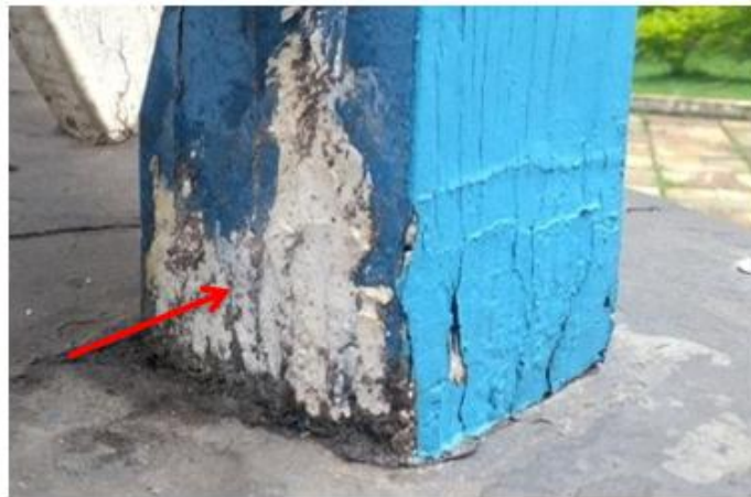
Figura 20: Apodrecimento da base da estrutura de madeira Fonte: Flávio Junior, 2021.
