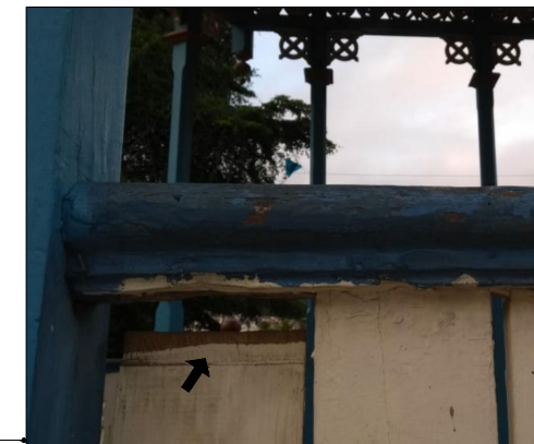
A – Detalhe perda do suporte na balaustrada Foto: Flávio Junior, 2019.
