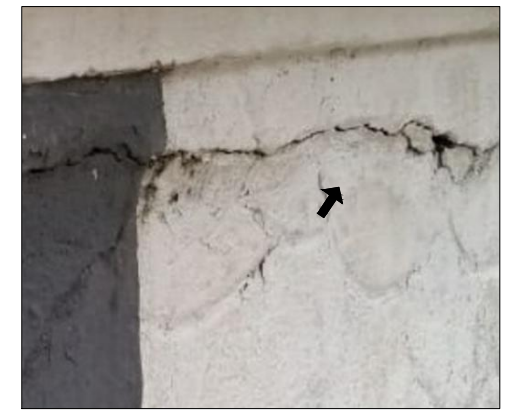
B – Detalhe da trinca na alvenaria Foto: Flávio Junior, 2021.
