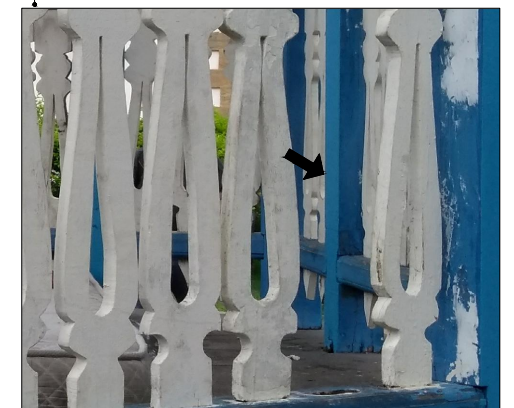
F – Detalhe perda do suporte na balastrada Foto: Flávio Junior, 2019.
