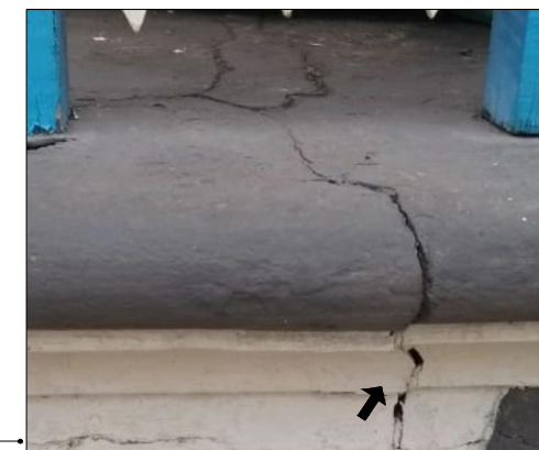
A – Detalhe da trinca na alvenaria Foto: Flávio Junior, 2021.
