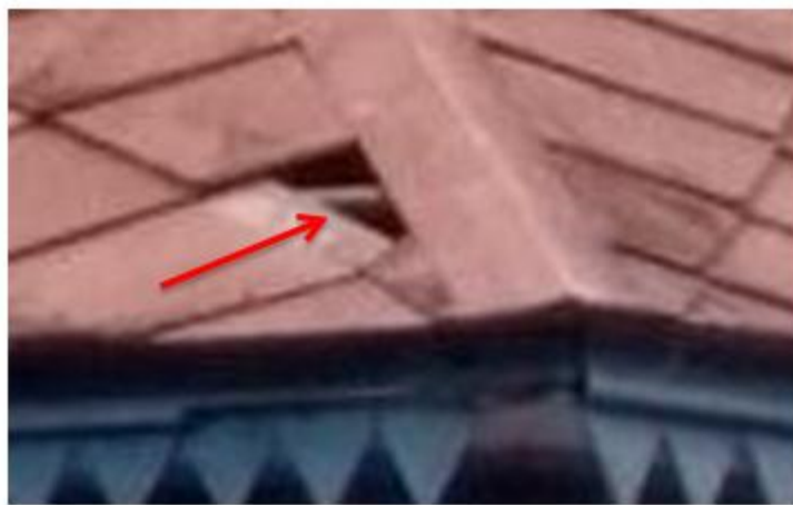
Figura 19: Perda de suporte na cobertura Fonte: Flávio Junior, 2021.
