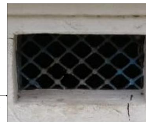
C – Detalhe oxidação da grade da esquadria J2 Foto: Flávio Junior, 2021.
