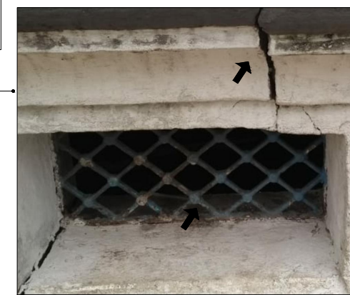
E – Detalhe oxidação da grade da J2 Foto: Flávio Junior, 2021.
