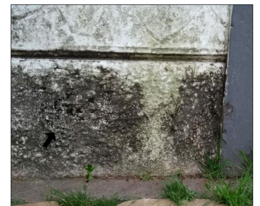
F – Detalhe Biofilme (fungos) na alvenaria Foto: Flávio Junior, 2019.
