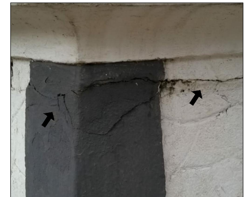
D – Detalhe trincas na alvenaria Foto: Flávio Junior, 2019.
