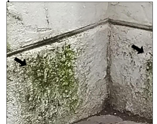
F – Detalhe biofilme (fungo) na alvenaria Foto: Flávio Junior, 2019.
