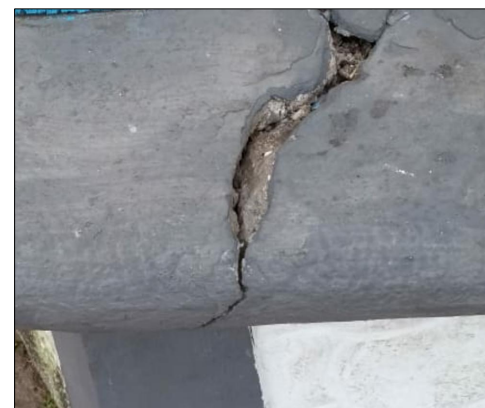
C – Detalhe Rachadura Foto: Flávio Junior, 2021.
