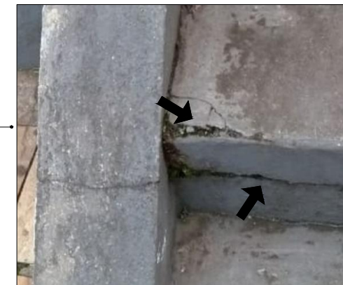
E – Detalhe trincas na alvenaria Foto: Flávio Junior, 2019.
