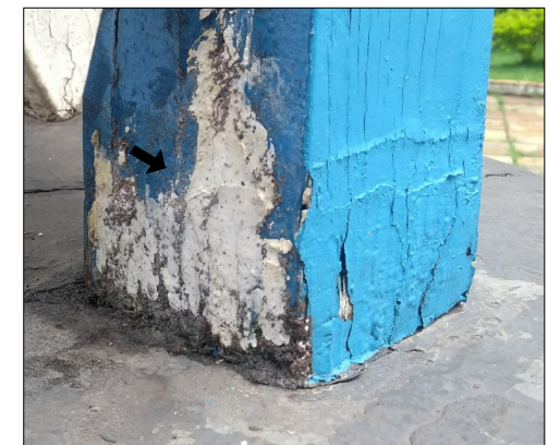
D – Detalhe apodrecimento do pilarete Foto: Flávio Junior, 2019.
