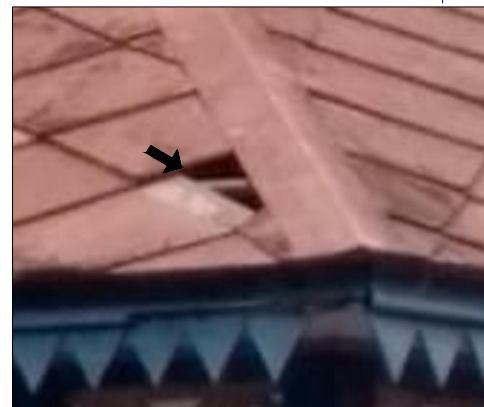
B – Detalhe perda da camada pictórica no pináculo e crosta negra na cobertura. Foto: Flávio Junior, 2021.
