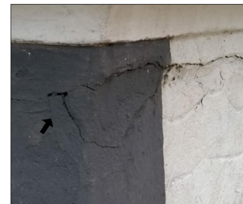
B – Detalhe da trinca na alvenaria Foto: Flávio Junior, 2021.
