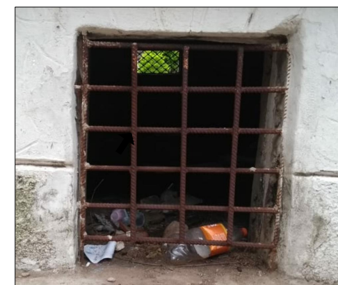
D – Detalhe oxidação da grade da esquadria P1 Foto: Flávio Junior, 2021.
