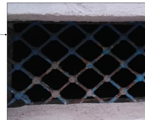
E – Detalhe oxidação da grade de ferro J2 Foto: Flávio Junior, 2019
