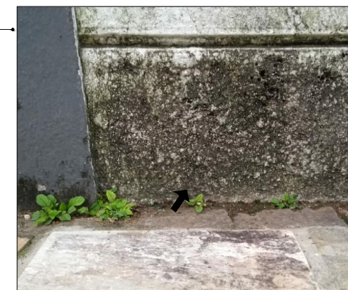
E – Detalhe Biofilme (fungos) na alvenaria Foto: Flávio Junior, 2019.
