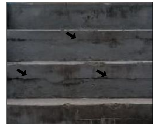
F – Detalhe trincas na alvenaria Foto: Flávio Junior, 2019.
