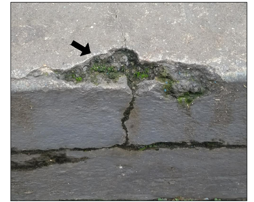
B – Perda da Argamassa na escada Foto: Flávio Junior, 2019.
