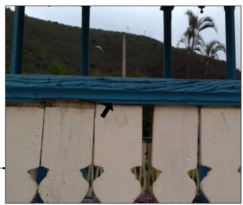
C – Detalhe perda do suporte/deslocamento Foto: Flávio Junior, 2021.
