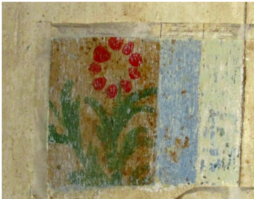
Figura 40: Decoração encontrada por baixo da pintura. Fonte: Cássia Miranda, 2019.
