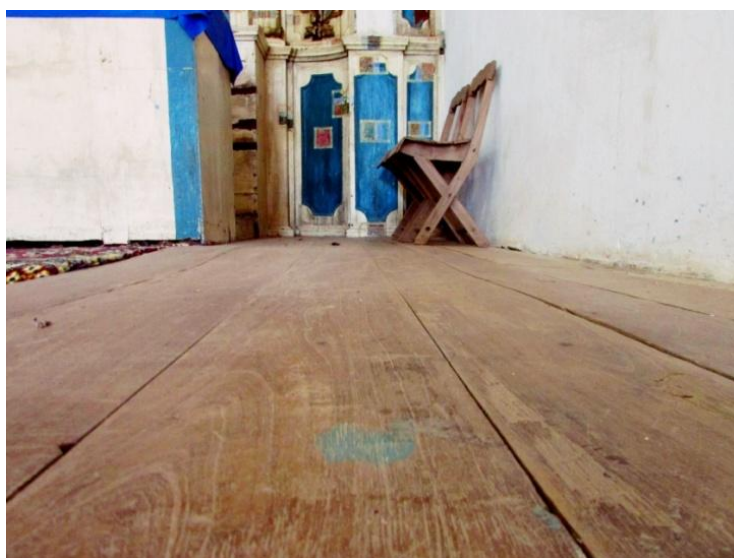
Figura 26: Piso de tabuado. Fonte: Cássia Miranda, 2019.
