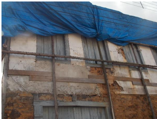
Foto 32. Fachada principal da edificação já com o barreamento amostra, bem danificado.
