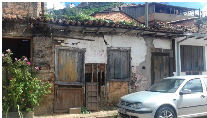
Foto 34. Casa em estado de arruinamento.
