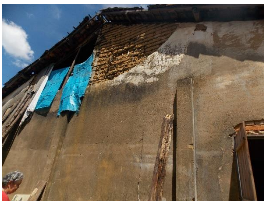
Foto 33. Fachada lateral da edificação, observa-se que o reboco na região da empena desprendeu.
