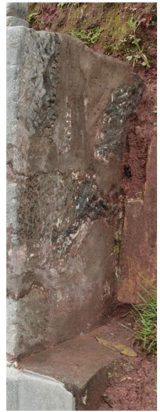
Argamassa por toda camada de pedra sabão intervenção inadequada. Umidade por capilaridade
