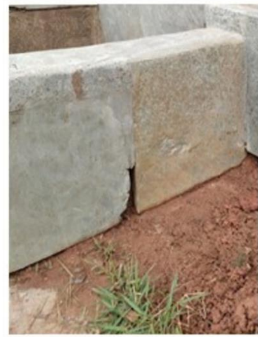
Oxidação da pedra de revestimento da bacia.
