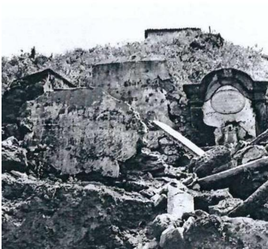
Figura 5 - Chafariz após ser atingido por queda de barreiras em 1960.
