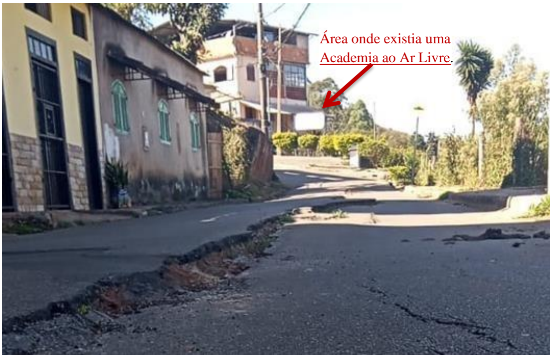
Figura 12 - Destaque para rua no entorno do Chafariz das Águas Férreas, apresentando rachaduras.
