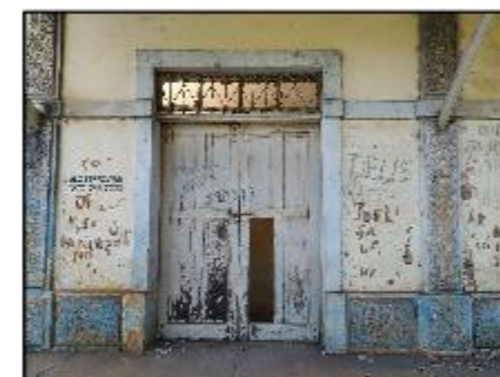
1_ Pixação, perda de material madeira da porta principal, vandalismo, esmaecimento da camada pictórica e sujidade generalizada
