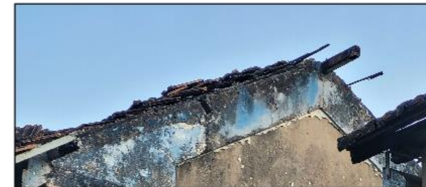
2 Perda de suporte e telhas da cobertura sujidade no telhado.
