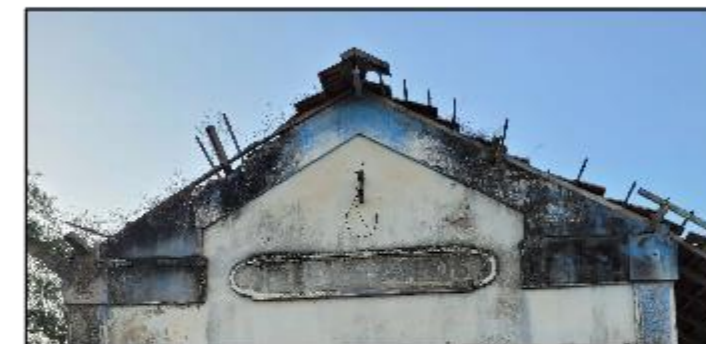
2_ Mancha de umidade, esmaecimento da camada pictórica e sujidade generalizada.
