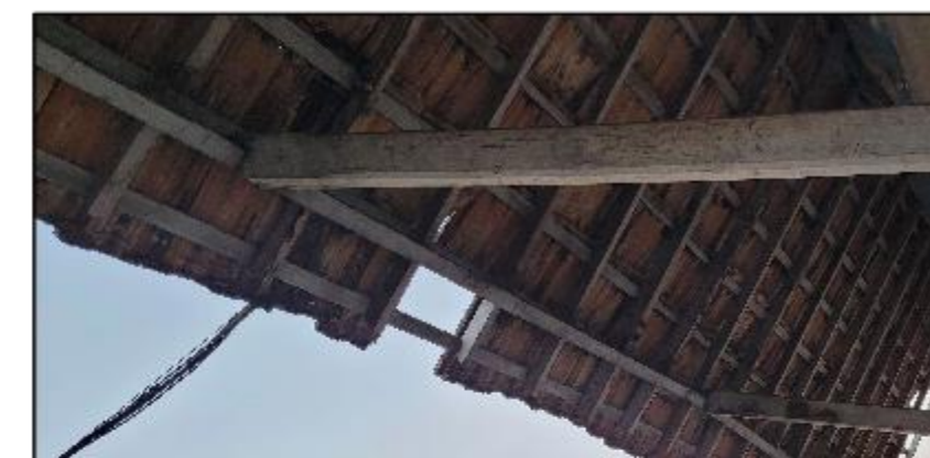
4 Perda das telhas da cobertura .
