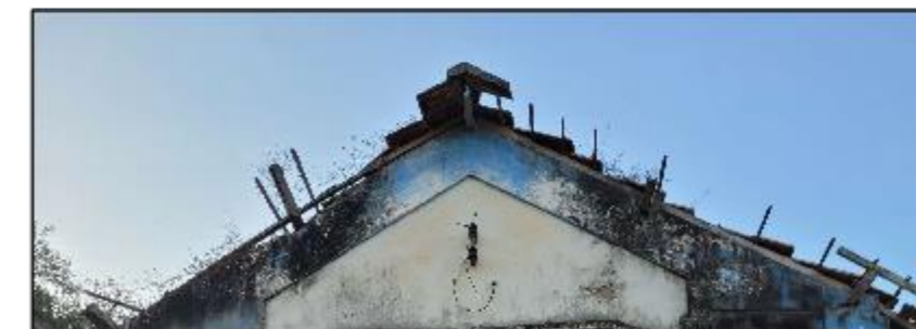
3 Perda de suporte e telhas da cobertura sujidade no telhado.
