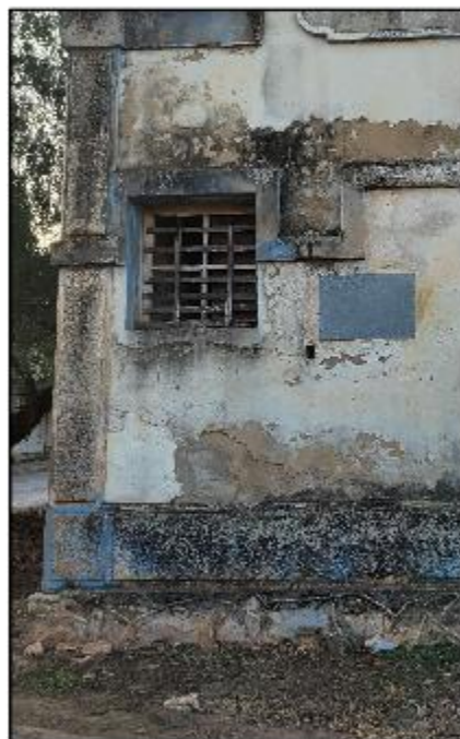
1_ Esmacimento da camada pictórica e sujidade generalizada e mancha de umidade
