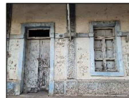
2_ Vandalismo esmaecimento da camada pictórica e sujidade generalizada.
