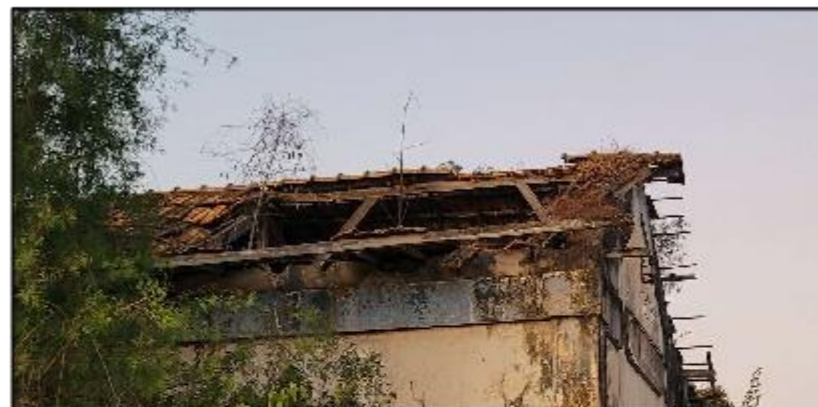
1 Perda de suporte e telhas da cobertura sujidade no telhado e vegetação de pequeno porte
