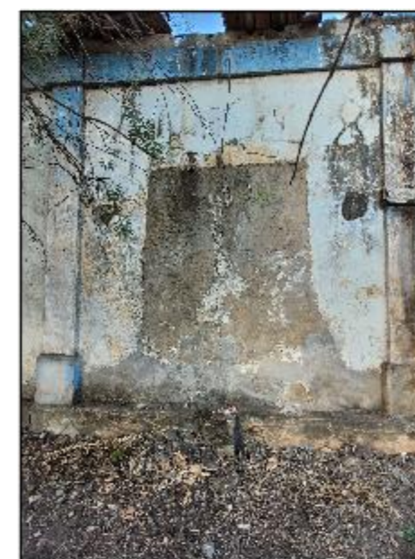
2 Perda de camada pictórica, mancha de umidade intervenção inadequada, esmacimento da camada pictórica e sujidade generalizada
