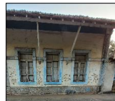
3_ Perda de material madeira da janela, vandalismo, esmaecimento da camada pictórica e sujidade generalizada
