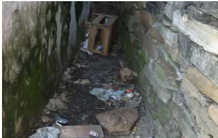
Figura 34- Patologias da fachada posterior
