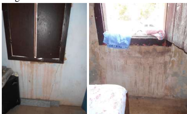
Figuras 70 e 71 - Manchas de escurimento
