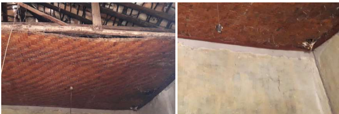
Figuras 58 e 59 - Forro de taquara abaulado e com sinais de apodrecimento
