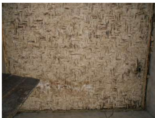
Figura 60 - Forro de taquara com avarias
