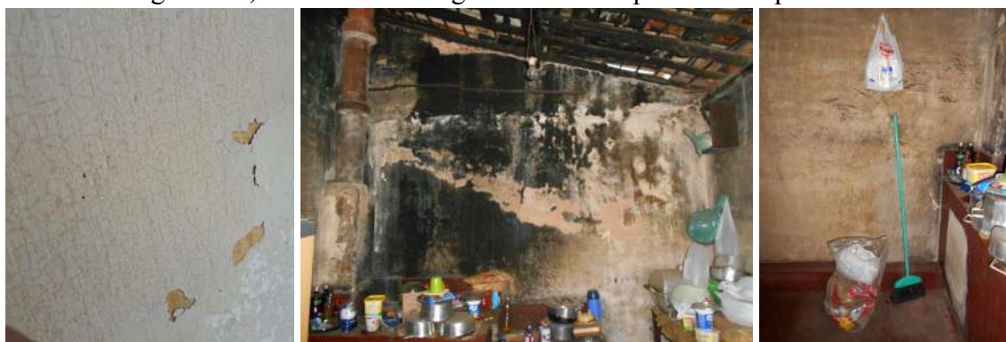
Figuras 61, 62 e 63 - Patologias na camada pictórica da parede
