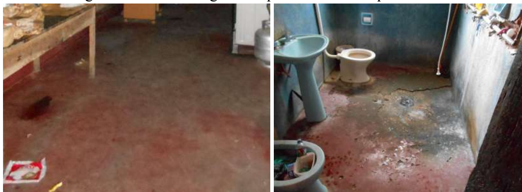
Figuras 68 e 69 - Desgaste do piso de cimento queimado
