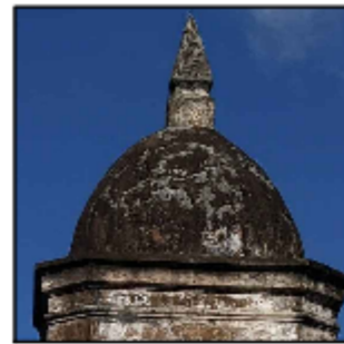
1: Mancha negra e biofilmena cúpula e no pináculo
