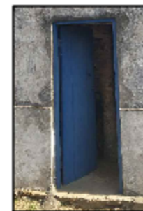
1: Vício de construção
