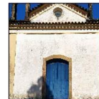
9: Sujidade e perda da camada pictórica
