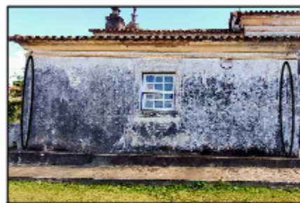
1: Mancha negra, biofilme, perda da camada pictórica e vício de construção
