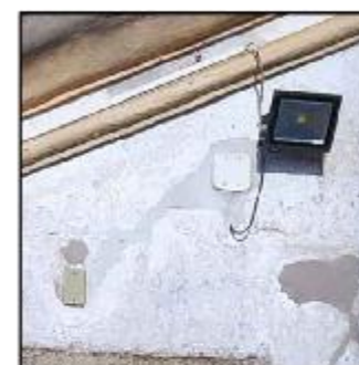
7: Vício de construção
