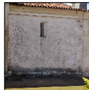
2: Sujidade e perda da camada pictórica, mancha negra e vício de construção
