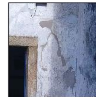
6: Vício de construção e perda da camada pictórica
