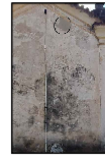
1: Mancha negra, perda da camada pictórica, perda da coloração da camada pictórica, vício de construção e biofilme
