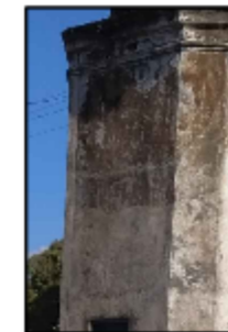
2: Perda da camada pictórica, macha negra e biofilme
