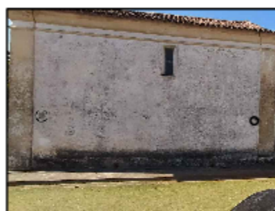
1: Sujidade e perda da camada pictórica, mancha negra e vício de construção
