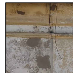
2: Vício de construção
