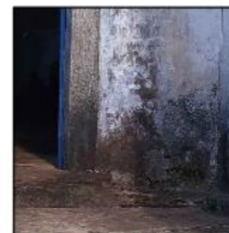
8: Mancha negra e perda da camada pictórica
