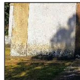
1: Mancha negra e perda da camada pictórica
