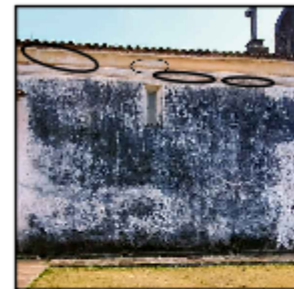
2: Mancha negra, perda da camada pictórica e perda da coloração da camada pictórica
