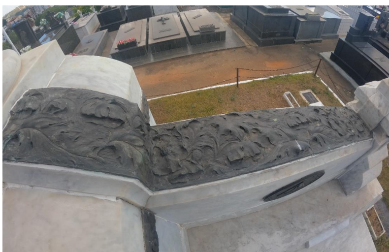
Figura 66 Detalhe da parte de cima da parede. - Jazigo da família Bias Fortes. Fonte: Cintia Murta Lima
