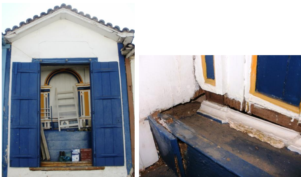
Patologias no Passo do Pretório Gilmar P. Nunes - 10/03/2013
