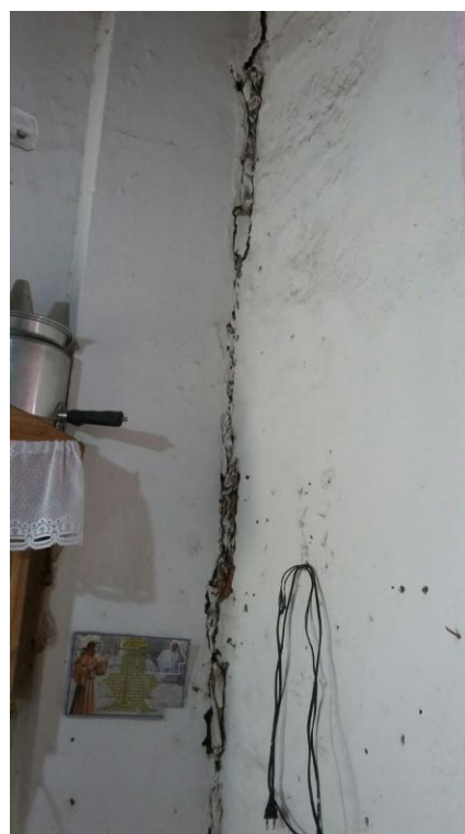
Figura 13: Lacuna na junta das paredes construídas em adobe/ taipa de pilão. FONTE: Acervo autora, 2017.
