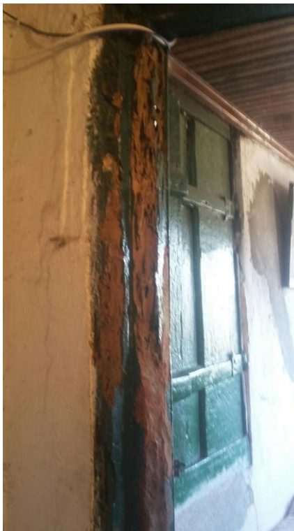
Figura 20: Marco com partes com perdas de ataque de insetos xilófagos e partes em processo de restauração. FONTE: Acervo autora, 2017.
