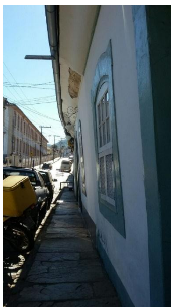
Figura 11: Desaprumo acentuado na fachada frontal do imóvel nº 480 da Rua Alvarenga. FONTE: Acervo autora, 2017.
