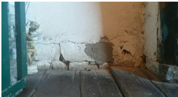
Figura 19: Trincas e rachaduras na alvenaria de pau-a-pique. FONTE: Acervo autora, 2017.
