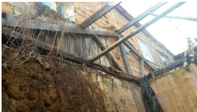
Figura 24: Peças remanescentes da estrutura do telhado. FONTE: Acervo autora, 2017.
