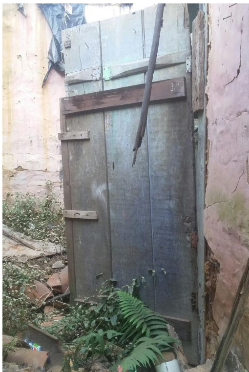
Figura 23: Porta do antigo quarto em estado avançado de deterioração. FONTE: Acervo autora, 2017.
