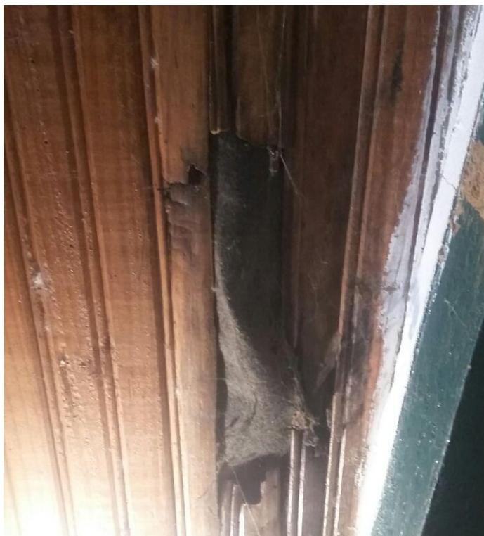
Figura 21: Apodrecimento do tabuado de madeira e perdas pontuais. FONTE: Acervo autora, 2017.
