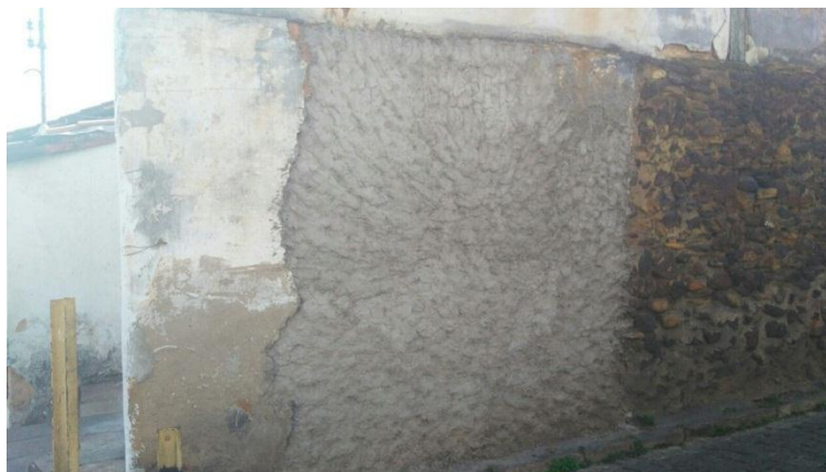
Figura 18: Intervenção inadequada com argamassa cimentícia na alvenaria de pedra. FONTE: Acervo autora, 2017.
