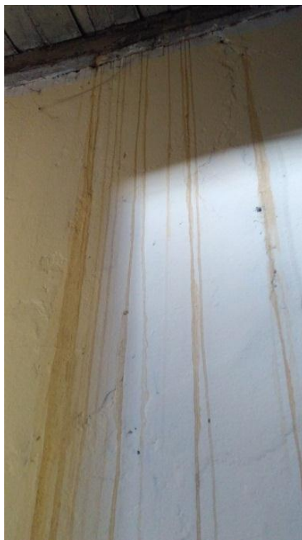
Figura 7: Mancha na parede do primeiro pavimento causada pela infiltração na cobertura. FONTE: Acervo Oficina de Restauro Público, 2017.
