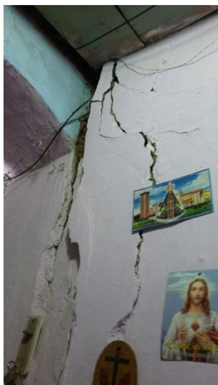
Figura 12: Rachadura no revestimento da parede construída em adobe/ taipa de pilão. FONTE: Acervo autora, 2017.
