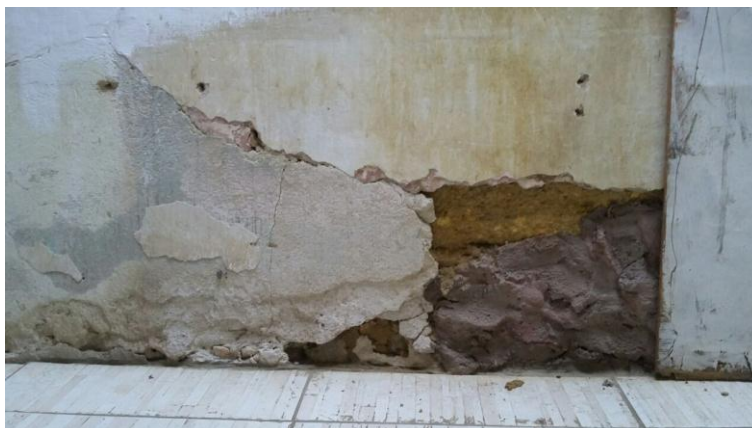
Figura 14: Descolamento do revestimento da alvenaria em terra crua e intervenção inadequada realizada com argamassa de cimento.
